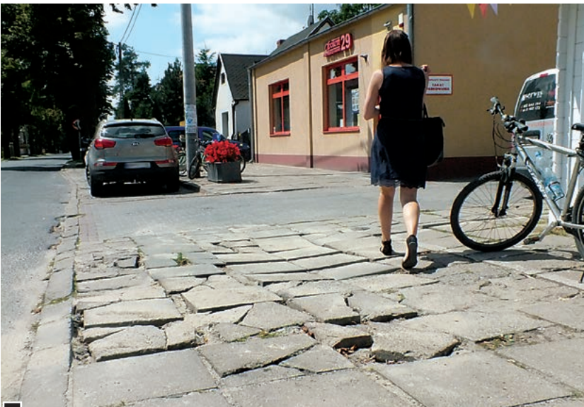
Zdezastrowane przez ciężkie samochody dojście do sklepu w Żabikowie fot. Hanna Siatka
