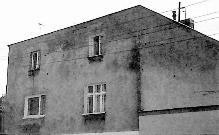
Ślady walk z 26 stycznia 1945 roku, na jednym z domów przy dzisiejszej ulicy Dąbrowskiego, w północnej części Lubonia. 2007 r. (Z.A.)
