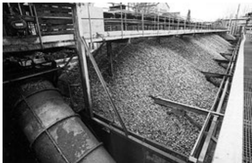
Konstrukcja zasobników umożliwiła pobór dowolnej partii zmagazynowanych ziemniaków fot. Przemysław Maćkowiak
