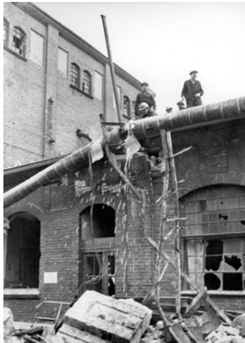
Usuwanie niebezpiecznych fragmentów uszkodzonej instalacji z sąsiadującego od południa niskiego budynku warsztatu mechanicznego, przyległego do Krochmalni III z suszarnią. fot. Kazimierz Przychodzki arch. „WL”
