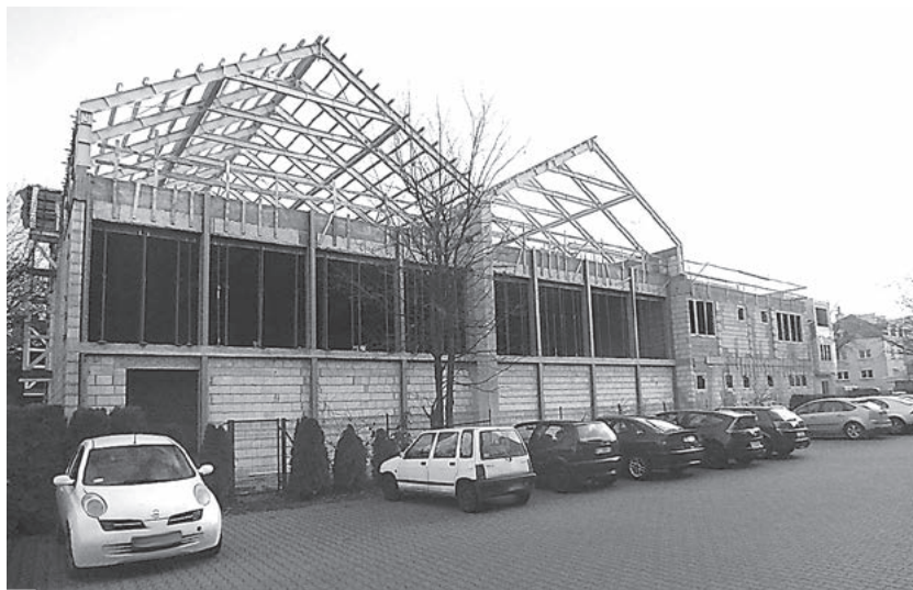
Widok budowanej szkoły katolickiej od ul. Przy Autostradzie. Od strony klasztoru (na zdjęciu – z prawej) konstrukcja dachu jest systematycznie przykrywana fot. Hanna Siatka
