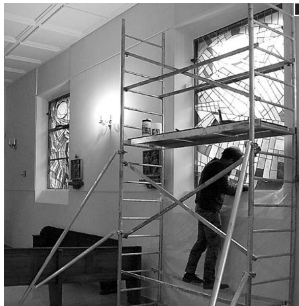
W prawej nawie montowane są kolejne witraże. To element przygotowania świątyni do uroczystej konsekracji fot. Piotr P. Ruzskowski
