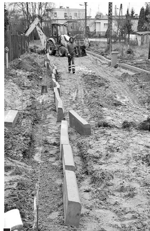
Po sznurku, na betonowej podsypce układa się obustronnie krawężniki oddzielające przyszłą jezdnię od chodników. Na zdjęciu budowa odcinka ul. Tuwima pomiędzy ul. Spadzistą a Cichą fot. Piotr P. Ruszkowski
