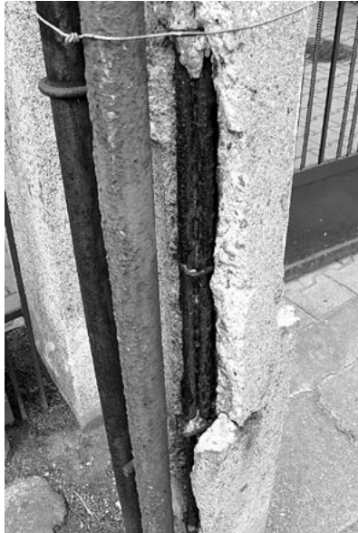
Fragment zniszczonego słupa energetycznego przy posesji nr 13 na ul. Dożynkowej. Stan z maja 2017 r. fot. Paweł Wolniewicz
