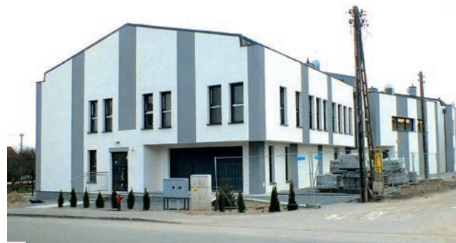
Kompleks przyszłych przychodni specjalistycznych z przedszkolem i apteką przy ul. Żeromskiego, w sąsiedztwie podobnej placówki („Med-Lux”) przy ul. Fabrycznej – widok z ul. Konarzewskiego fot. Hanna Siatka
