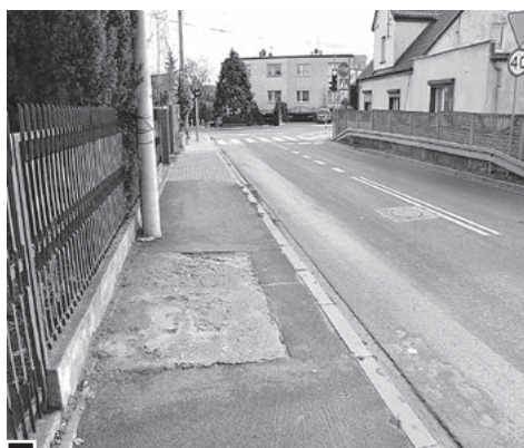
Niewiadomego pochodzenia betonowa wylewka na równym, asfaltowym chodniku ul. Polnej
