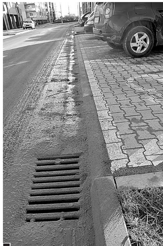
Kto nie traci wyobraźni, widzi jak zapychane muszą być rury kanalizacji deszczowej w alei JP II, jeżeli takie błoto zalega w rynsztoku. Przy konieczności nagłego hamowania, poślizg na takiej nawierzchni jest nieunikniony. Czy i jak zaradzą temu decydenci? fot. Piotr P. Ruszkowski
