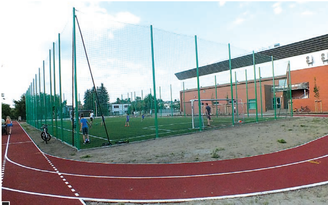
Kompleks sportowo-rekreacyjny przy SP 5 i hali widowiskowo-sportowej – widok boiska do piłki nożnej od strony ul. Wojska Polskiego. Szkoda, że nie zadbano o kawałki gruntu pomiędzy bieżnią i placami do gry. Pozostawiono w tych miejscach ziemię m.in. z resztkami po budowie fot. Hanna Siatka
