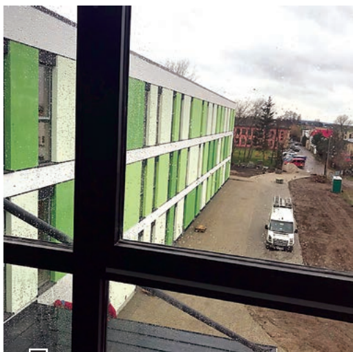
Nowo powstający Ośrodek OREW EMEDEA przy ul. Sobieskiego – widok z balkonów wejścia głównego
