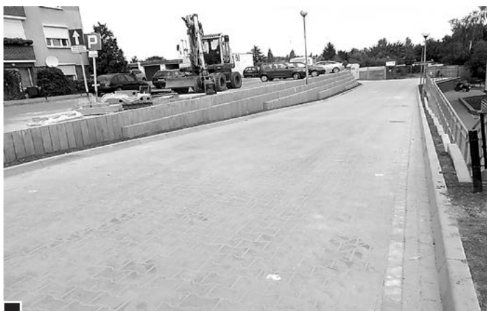
Nowa, boczna droga od ul. Sikorskiego do Rodzinnego Ogrodu Działkowego „Bratek”. W głębi – brama wjazdowa Ogrodu i niewidoczne, za skarpą po lewej stronie, przy ogrodzeniu ROD – miejsca parkingowe (postój przewidziano także wzdłuż drogi) fot. Hanna Siatka
