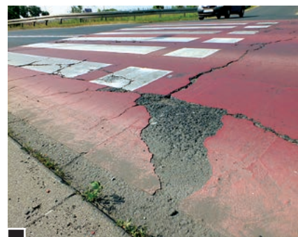
■ Spowodowane pękaniem asfaltu ubytki w oznakowaniu przejścia dla pieszych przez ul. Unijną przy wejściu do parku Papieskiego na wysokości Rodzinnego Ogrodu Działkowego „Bratek” fot. Hanna siatka
