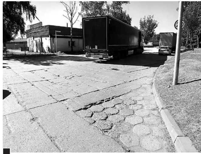
Wyboista droga, którą do Ośrodka Rehabilitacji muszą pokonywać niesprawni ruchowo mieszkańcy fot. Hanna Siatka
