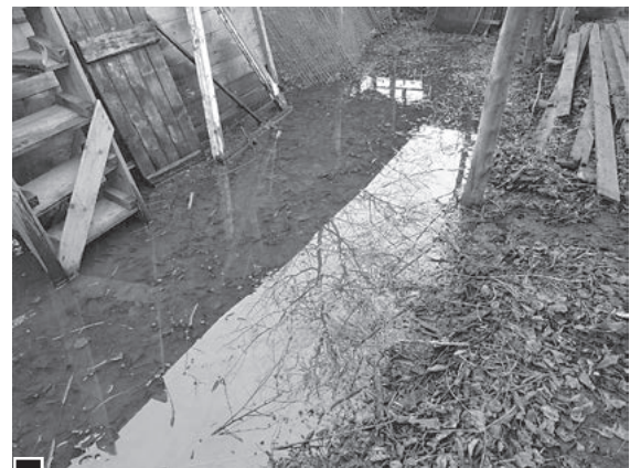
Stojąca woda gruntowa na podwórku posesji przy ul. Szymanowskiego
