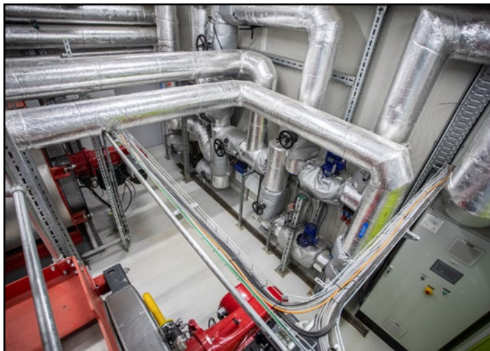
Nowoczesna instalacja grzewcza w elektrociepłowni fot. Zb. GETEC
