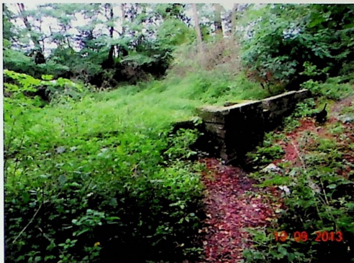
Fot. 89. Piotrowo – wyschnięty strumień, zaniedbany przepust
