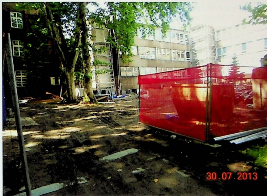
Fot. 17. Wilda – dewastacja ogrodu szpitalnego
