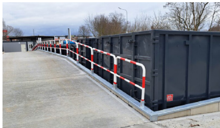
Rampa rozładunkowa nad kontenerami hakowymi fot. Kom-Lub Sp. z o.o.
