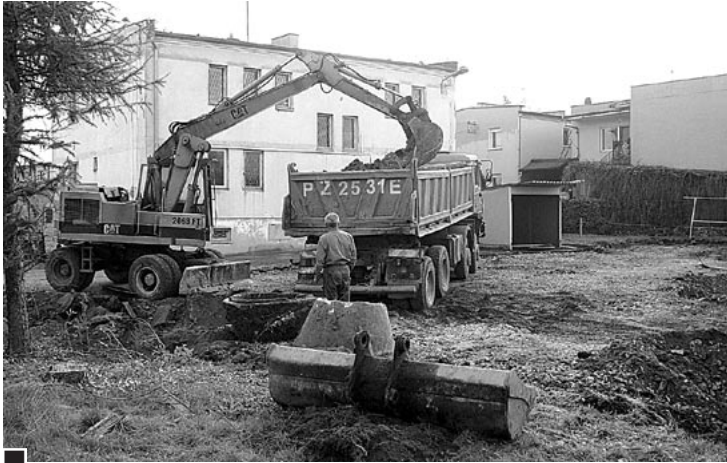
Po otrzymaniu dokumentacji projektowej oraz pozwolenia na budowę, pod koniec października przy ul. Powstańców Wielkopolskich rozpoczęto budowę nowego komisariatu fot. Paweł Wolniewicz
