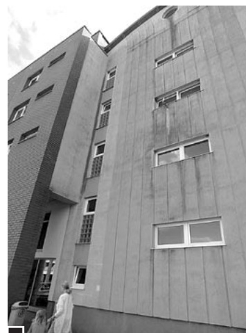
Zniszczona elewacja najstarszego budynku w NCL z adresem ul. Wschodnia 22, postawionego przez Budo-Formę w 2003 r. fot. Hanna Siatka
