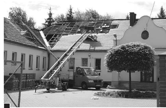
Wymiana starej dachówki karpiówki na nową w Przedszkolu „Tip-Topka Odkrywcy” przy ul. Konarzewskiego (brak informacji o tej inwestycji w oficjalnym wykazie UML) fot. Piotr P. Ruszkowski
