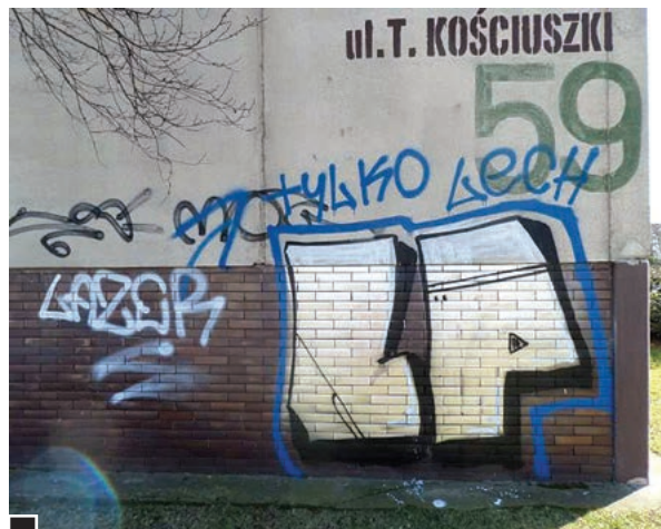
Zniszczona przez graffiti elewacja bloku przy ul. Kościuszki 59
