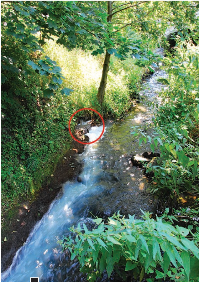
W gąszczu skarpy Strumienia Junikowskiego prawie niewidoczne nielegalne przyłącze oznaczone przez nas czerwonym okręgiem fot. Piotr P. Ruszkowski
