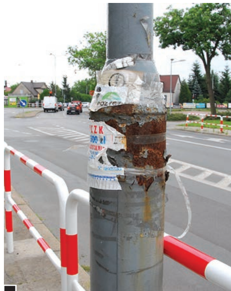
Dzisiejszy stan – słup latarni miejskiej na ul. 11 Listopada (okolice skrzyżowania z Kościuszki) z wyraźną korozją stali wywołaną klejami plakatów, ogłoszeń itp. fot. Piotr P. Ruskowski
