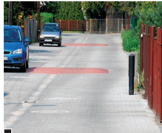
W pasie drogowym znalazły się, niestety, słupki telefoniczne. Po ciemnych śladach opon widać, że przeszkody są wyraźnie omijane fot. Piotr Ruszkowski
