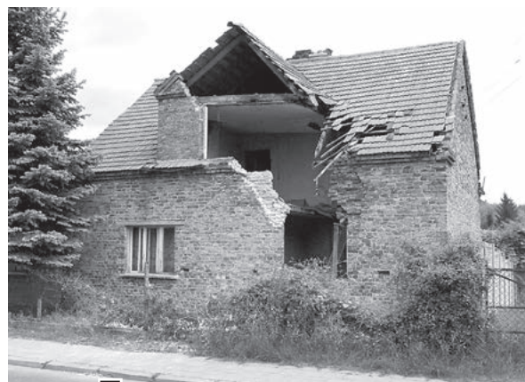
W środku nocy, przez zapadnięcie się nadproża okiennego, które pociągnęło za sobą część konstrukcji, zawalił się fragment domu przy ul. 3 Maja 14 fot. Piotr P. Ruskowski
