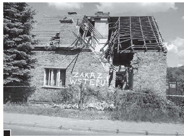
Dom nadal stoi. Pat prawny nie pozwala rodzinie na rozebranie niebezpiecznej części, pozostawia na nich jednak odpowiedzialność za ewentualne skutki. Zabezpieczeniem dla poszukiwaczy metalu – tragarzy stropowych ma być napis „ZAKAZ WSTĘPU!” fot. Piotr P. Ruskowski
