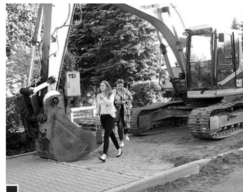
Przed siedzibą komisji wyborczej w Szkole Podstawowej nr 4 trwała budowa ulicy 1 Maja. Przed dniem wyborów wykonawca skończył układanie chodnika metr przed wejściem do szkoły. Wyborcy byli więc zmuszeni przechodzić pomiędzy łyżką koparki a pojazdem fot. Roman Haremza
