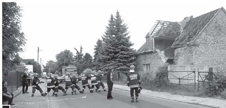
Strażacy z OSP podczas jednej z prób sprowokowania zawalenia się prawostronnej konstrukcji domu. Bezskutecznie w ósemkę ciągną za linę. Akcją kieruje także inspektor nadzoru budowlanego fot. Władysław Szczepaniak
