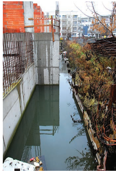
Woda przy fundamentach sięgająca ponad metr wysokości, a wewnątrz hali garażowej ok. 0,80 m, budzi obawy co do stabilności budynku w gliniastym gruncie fot. Piotr P. Ruskowski
