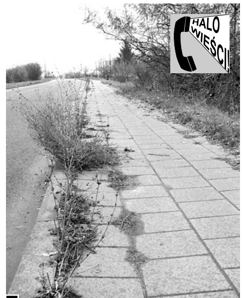
Zarosnięty chodnik na lubońskim odcinku ul. Przy Autostradzie fot. Hanna Siatka
