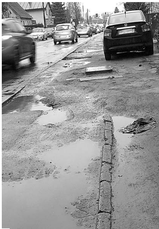
Łaty, kałuże w głębokich dziurach, różnice terenu pomiędzy pozostałościami po asfalcie(?) a gruntem i wystająca studzienka telekomunikacyjna – „chodnik” po nieoświetlonej stronie ul. Sobieskiego, na odcinku od Targowej do Żabikowskiej fot. Hanna Siatka
