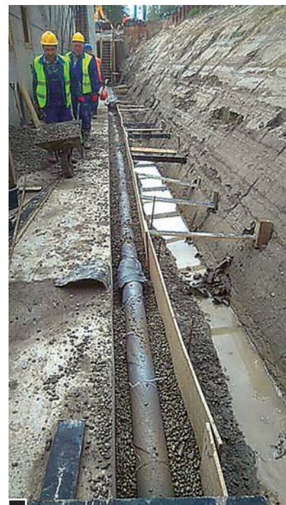
Zgodnie z oświadczeniem inwestora i zdjęciami, które nam przesłał, system drenażowy wokół inwestycji przy ul. Wschodniej 19 jest gotowy fot. arch. NCS-Bud
