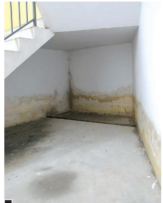
Stopień permanentnego zawilgocenia ścian piwnicy na klatce schodowej fot. Piotr P. Ruszkowski
