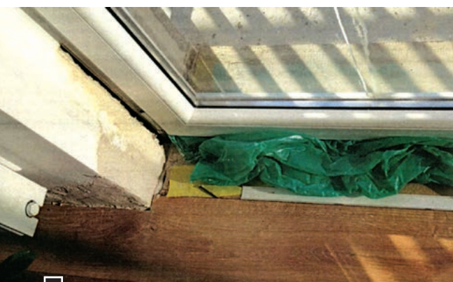
Zaciek murów i tynków wewnątrz jednego z mieszkań o złej izolacji płyty balkonowej fot. „Opinia techniczna”
