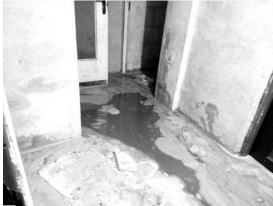
Piwnica domu państwa Lisieckich całkowicie zalana przez deszczówkę, która powoduje zawilgocenie ścian i stolarki drzwiowej
