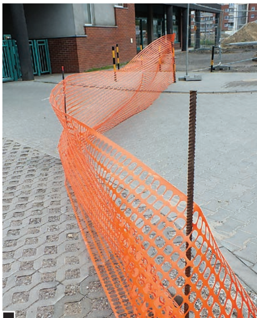
Niedbale zabezpieczone przejście przy rondzie budowanym w NCL, od strony ul. Pułaskiego. Aż strach pomyśleć, co się stanie, kiedy będzie tędy przechodzić grupa rozbawionych dzieci czy młodzieży, popychając się wzajemnie fot. Hanna Siatka
