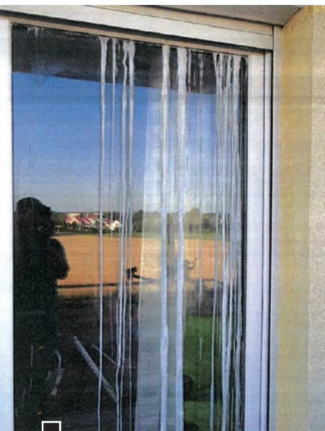
Zacieki agresywnych środków chemicznych na szybach i stolarce okiennej fot. „Opinia techniczna”
