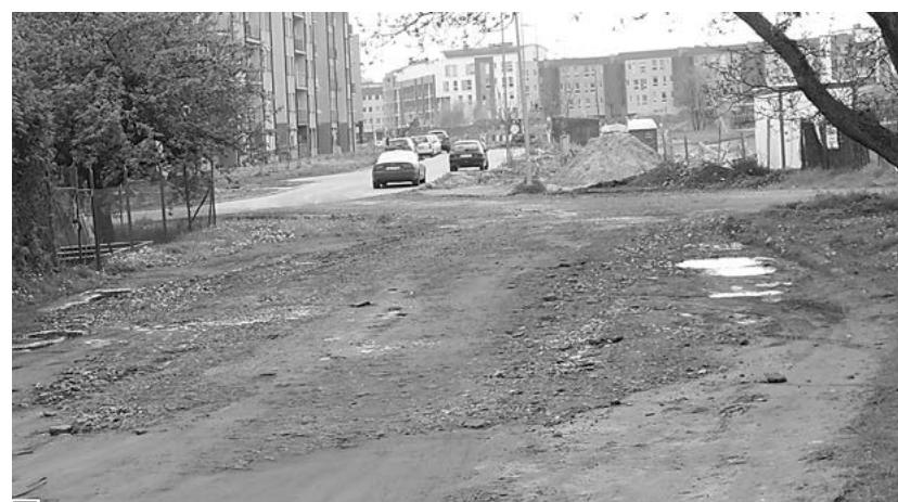
Wysypano kruszywem wjazd na prywatną drogę, obecnie wykorzystywaną przez miasto jako objazd dla budynków przy al. Jana Pawła II nr 3 i 5 (w głębi z lewej) – w przyszłości przedłużenie alei do ul. Powstańców Wlkp. Z prawej – wjazd na teren rynekczu fot. Hanna Siatka
