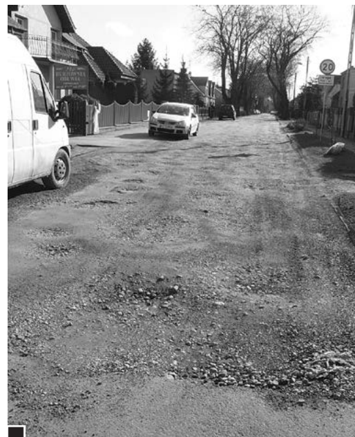
Fatalny był również stan ul. Kopernika u jej zbiegu z ul. Wschodnią Niedawno została wyrównana fot. Paweł Wolniewicz
