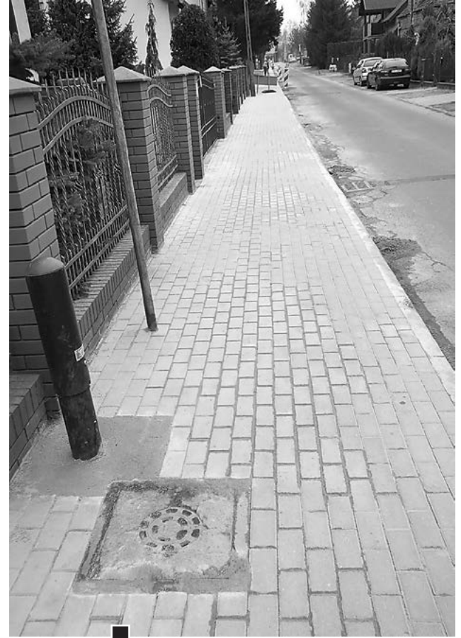
Nowy, pzbbrukowy chodnik na ul. Sienkiewicza, od ul. Kościuszki do ul. Przejazd. Przydałby się jeszcze remont asfaltowej jezdni fot. Hanna Siatka
