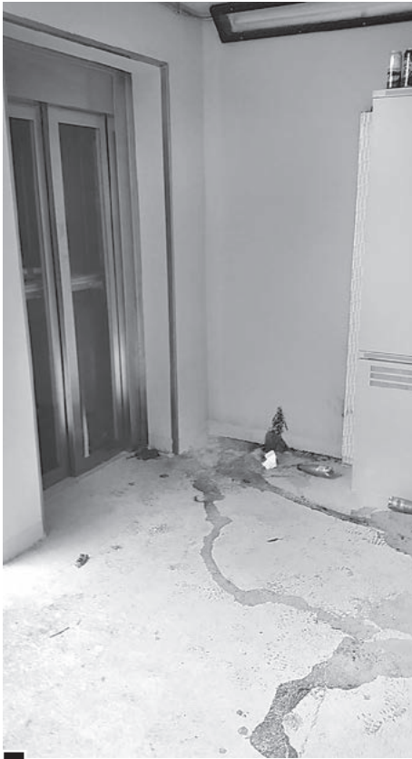
Zanieczyszczone fekaliami okolice windy w nowym przejściu podziemnym przy ul. Fabrycznej (2 kwietnia)
