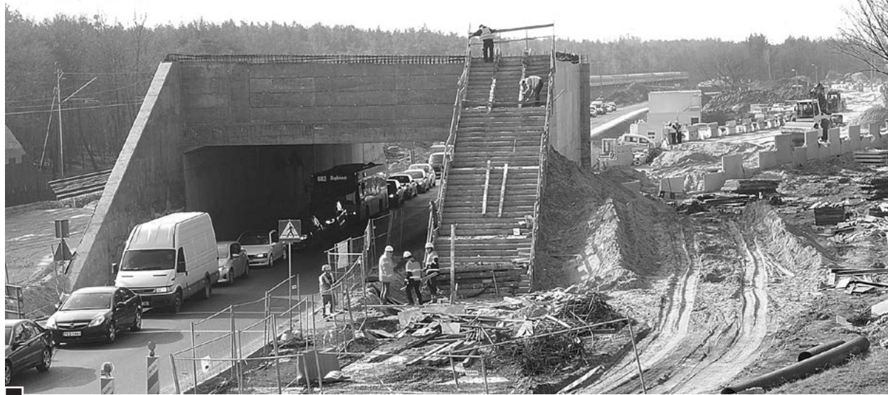
Wiadukt nad przedłużeniem ul. Krętej w kierunku Łęczycy, na który prowadzi prawie 50 stromych stopni z podestami przystankowymi co 12 stopni (wysokość ok. dwóch pięter). Nie przewidziano nawet windy. Wózki, niepełnosprawni, rowerzyści będą skazani na przebycie dodatkowych 1000 m (do ronda w Łęczycy i z powrotem – drogą 430 biegnącą górą). W tunelu wiaduktu sznur samochodów stoi na przedłużeniu ul. Krętej (z chodnikiem) w kierunku Łęczycy fot. Piotr P. Ruszkowski
